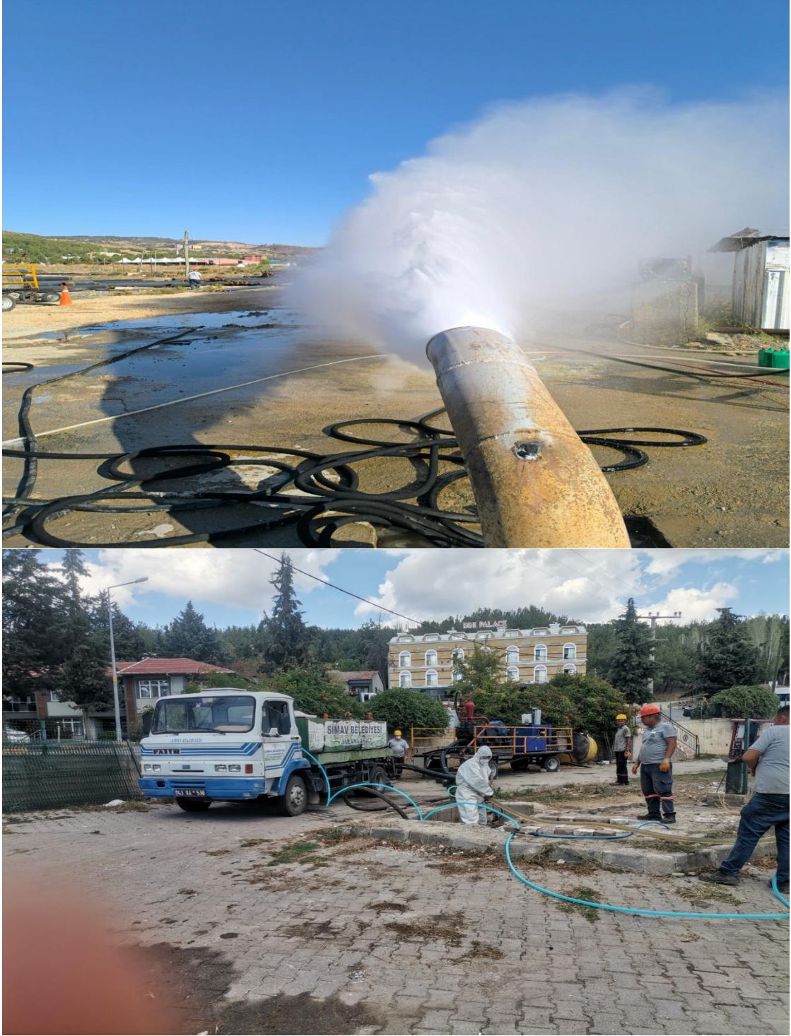
3-Kanal kuyubaşı ısı merkezi seperatör tankları büyütme çalışması
